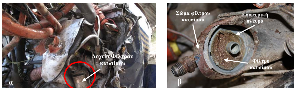
Φωτ. 24: Το φίλτρο καυσίμου του κινητήρα με το μερικώς ανοικτό δοχείο του φίλτρου (Φωτ. α) αλλά και το φίλτρο μετά από την αφαίρεση του δοχείου (Φωτ. β).
