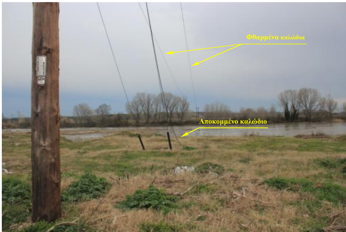
Φωτ. 6 Οι πυλώνες της ΔΕΗ, τα φθαρμένα καλώδια και το αποκομμένο.
