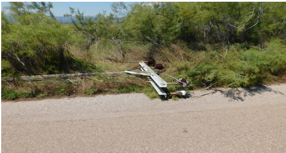
Φωτ. 3: Η κολώνα μεταφοράς ρεύματος μετά την πτώση της
