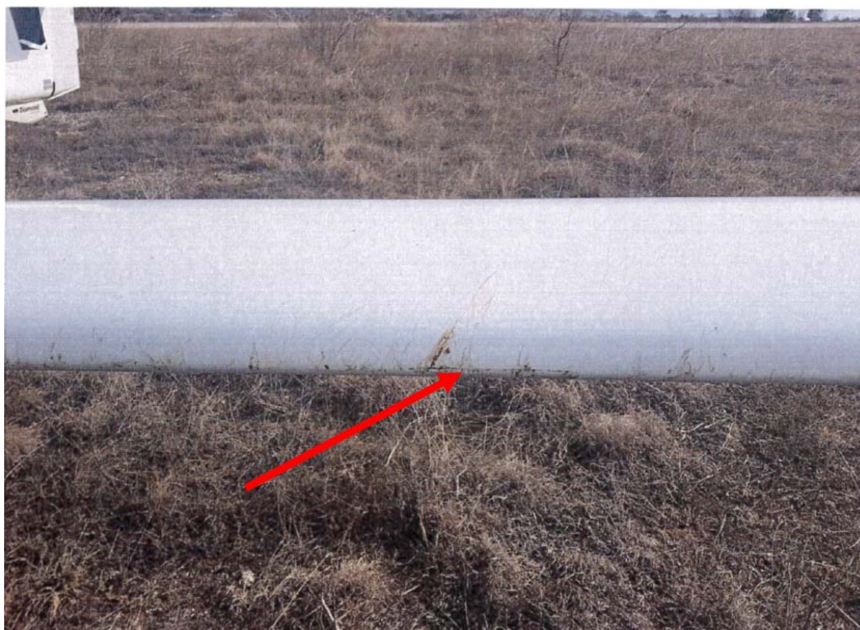
Φωτ. 2: Αριστερή πτέρυγα με την ρωγμή μήκους 22 χιλιοστών (22 mm).
